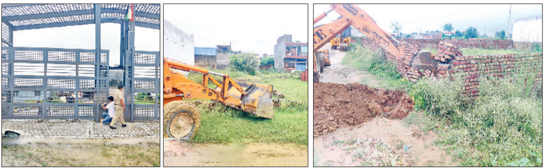
सोनीपत। भवन को सील करते हुए निगम कर्मचारी व अवैध कॉलोनी में निर्माण कार्य तोड़ते हुए।
